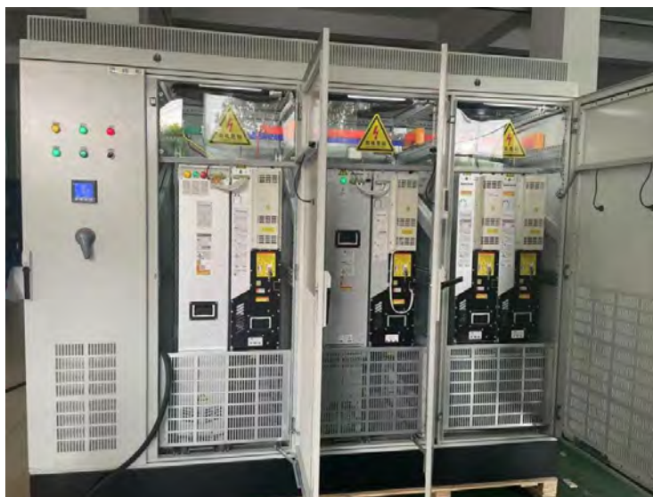
Шкаф оснащен Multi-drive внутри с: R8 (AIM+ALM)*2+R8(SMM) *2
